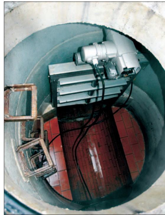
Bild 2: Eingebauter Schacht mit Schieber und Stellantrieb
