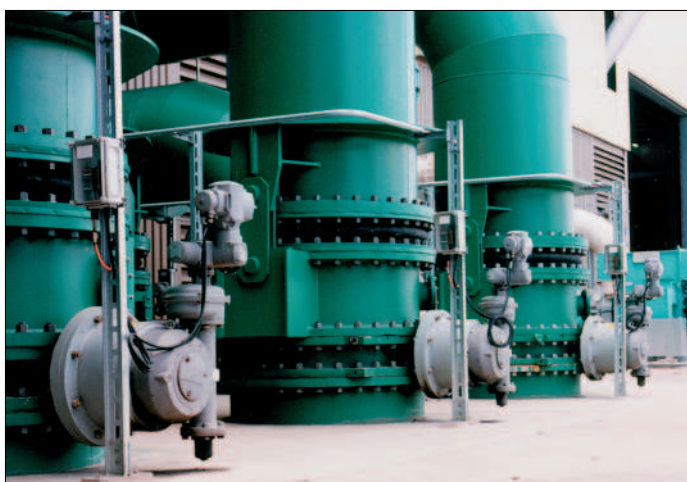
Bild 7: Drehantriebe auf Schwenkgetrieben in einem Kohlekraftwerk
